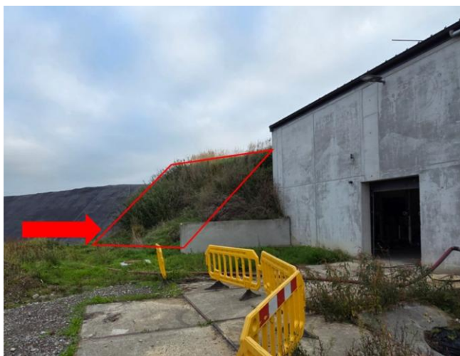
Foto 2 – Pompgebouw en berm. Ter hoogte van de rode markering wordt de berm (breedte ± 4 m) gedeeltelijk weggehaald zodat een kraan het bekken kan binnenrijden om de herstellingen aan de binnenkant uit te voeren.
